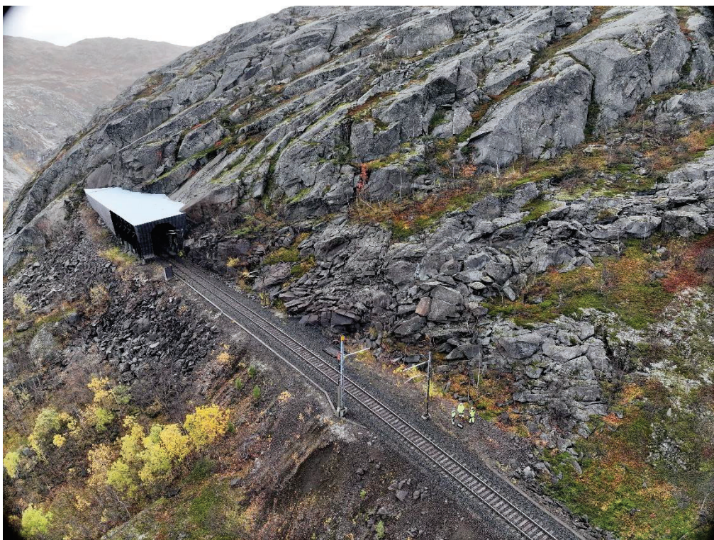
Figur 4.3 Terrenget er bratt, og bildet viser løse blokker i terrenget ovenfor dagens spor. mellom snøoverbygget og takoverbygget/tunnel ved km 24,500.
