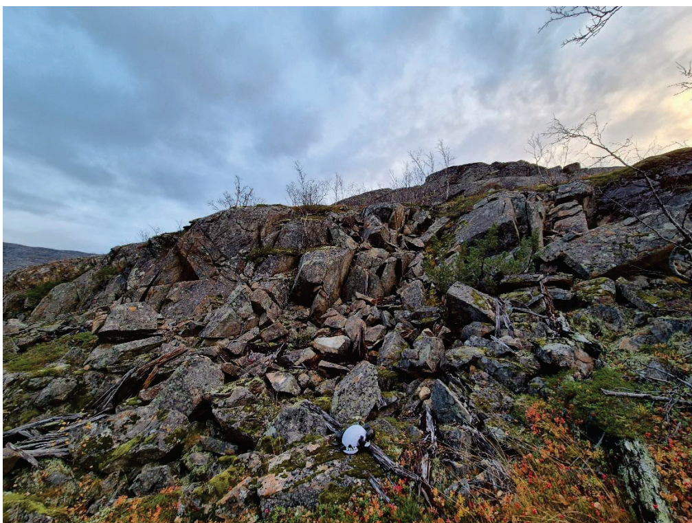
Figur 4.2 Løse blokker i området ved tunnelpåhugget i sør-vest. Hvit hjelm som målestokk
