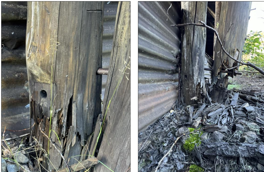
Figur 4-9 Bilder av bæresystem - søyler i svært dårlig tilstand. Kilde: Bane NOR/Tobias Ekhorn Jenssen
