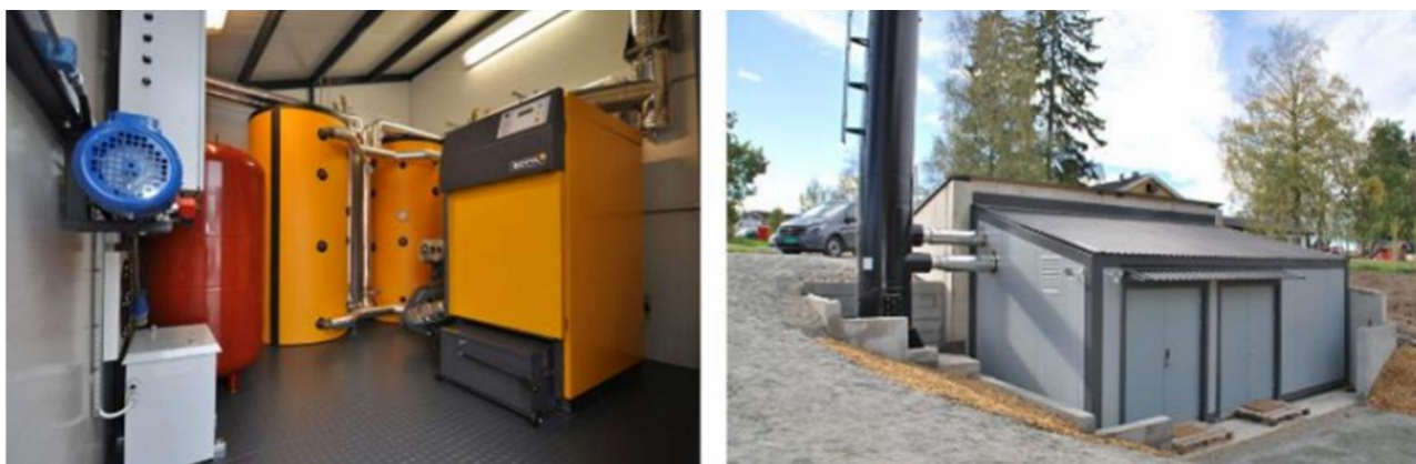
Figur 2.7 Eksempel på modulbasert varmeanlegg. (kilde: ETA Norge AS)
