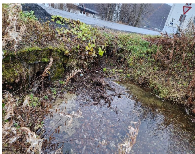
Figur 2: Bilde av innløp overvannsrør i krysset, Beisfjordveien, Kløverveien. På bilde ser man at innløpet er delvis tettet av vegetasjon og erodert masse
