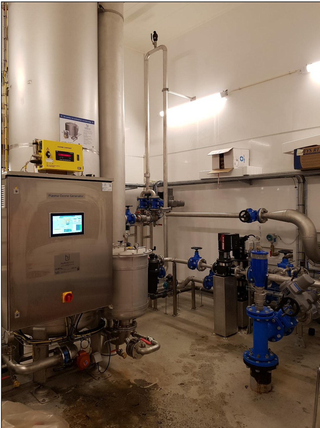
Bilde 9.3: Prosessstyr Djupvik vannverk.
