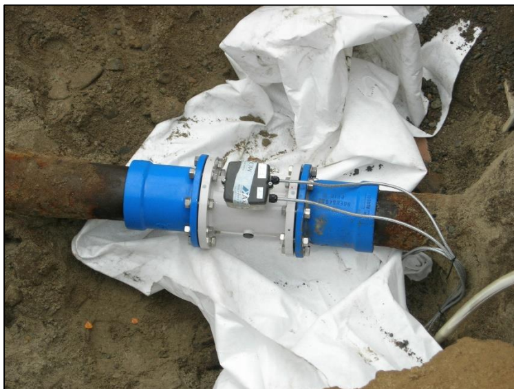
Bilde 11.1: Nedgravd vannmåler på nett.
