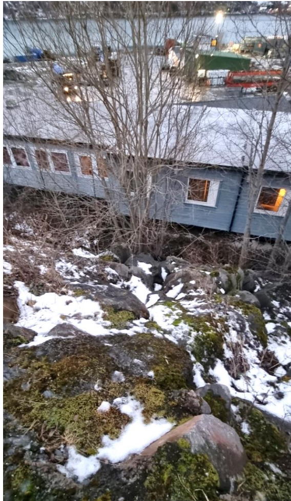
Bilde 1: Kritisk skråning. Bilde tatt mot sørvest. Viser store blokker.
