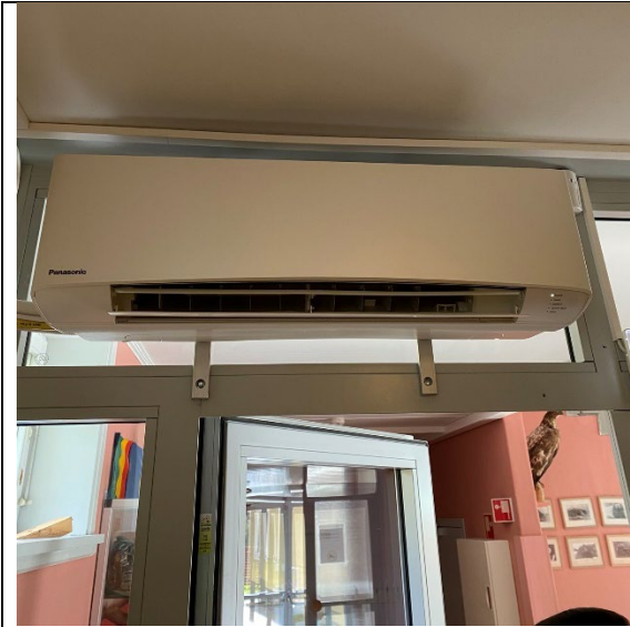
Plassering: Gammelfløya 1. etg. korridor EE-type: Varmepumpe
