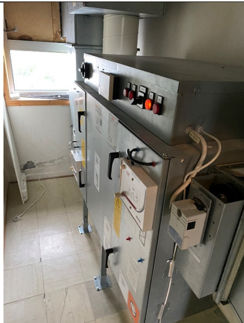
Plassering: Spesialfløya, 103, teknisk rom tilknyttet klasserom EE-type: Ventilasjonsaggregat, merket med 98
