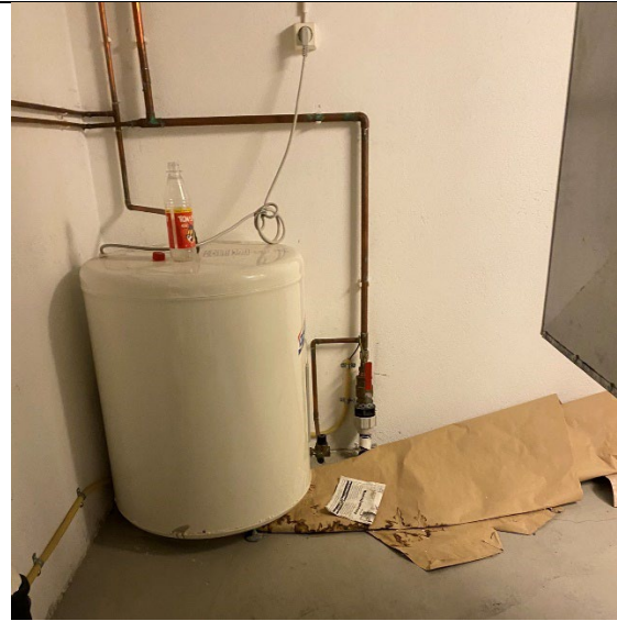
Plassering: Administrasjonsfløya, aggregatrom EE-type: Varmvannsbereder
