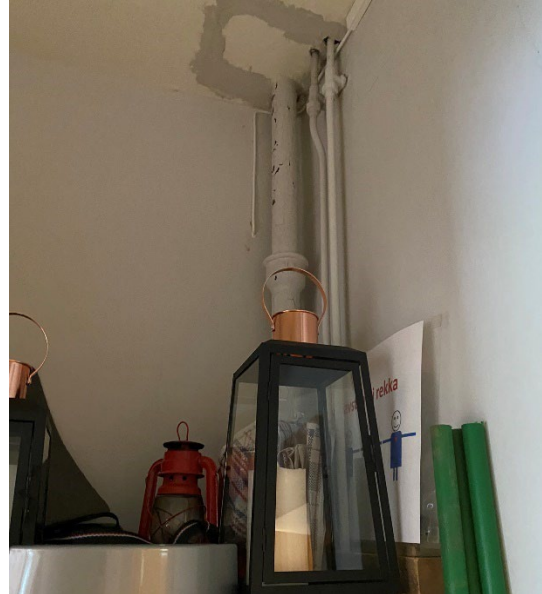
Plassering: Gammelfløya, 1. etg. Materialtype: Rørgjennomføring Antall: 2 stk.
