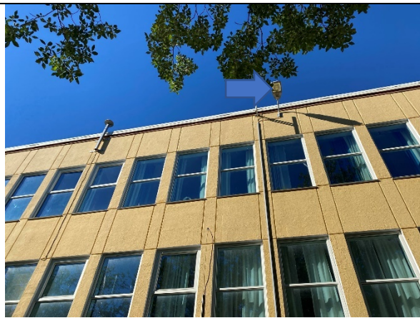
Plassering: Fasade nyfløya EE-type: Lysarmatur, eldre
