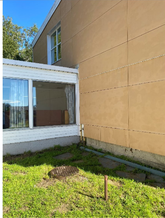
Plassering: Fasade Materialtype: Påfyllingspunkt for oljetanken
