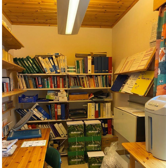
Plassering: Administrasjonsfløya EE-type: Lysarmatur med lysrør
