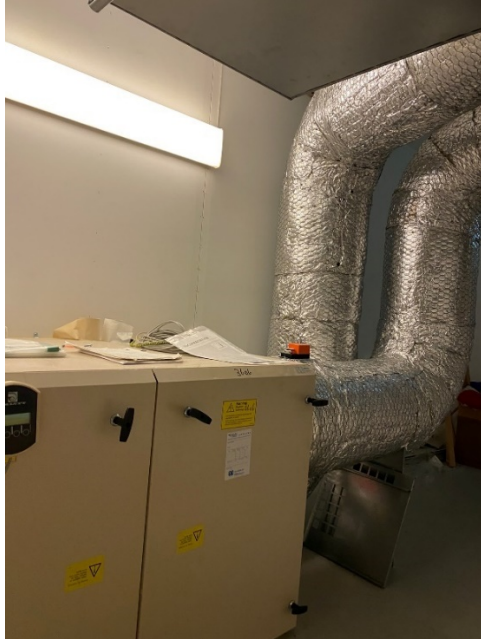
Plassering: Administrasjonsfløya, aggregatrom EE-type: Ventilasjonsaggregat, merket med 2012
