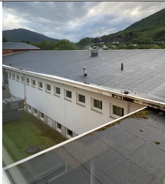
Plassering: Tak på deler av gammelfløya Materialtype: Asfaltbasert takpapp Verdi/antall: Hele takarealet
