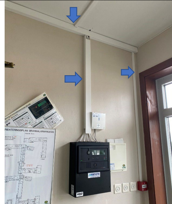
Plassering: Gammelfløya, vindfang ved norcemhall EE-type: Kabelkanal, systemskap
