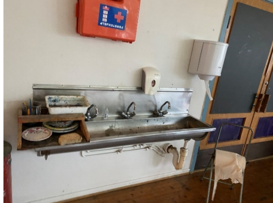
Plassering: Sløyd, 1.etg. nyfløya Materialtype: Soilrør og utslagsvask Verdi: 1 stk.
