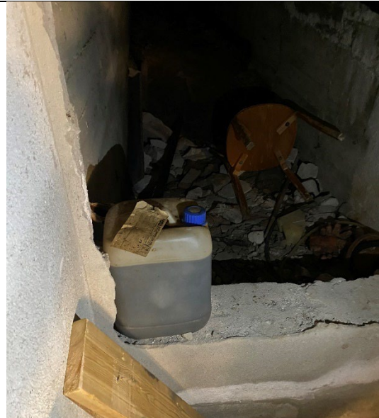
Plassering: Spesialfløy, rom ifm. kjeller under svømmehall Materialtype: Hensatt kjemikalie Antall: 1 stk.
