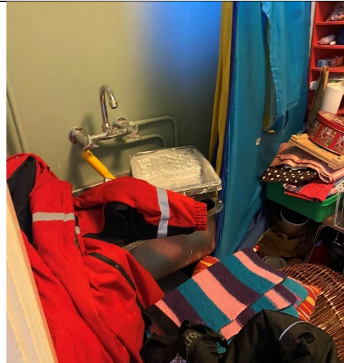
Plassering: Spesialfløya, lager Materialtype: Utslagsvask og rørgjennomføringer Verdi: 1 utslagsvask, trolig flere rørgjennomføringer som er klassifisert som asbestholdige.
