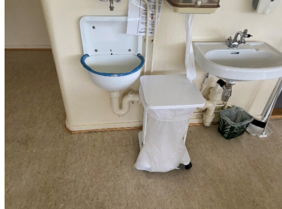
Plassering: Spesialfløy, heimkunnskap Materialtype: Soilrør og utslagsvask Verdi: 1 stk.
