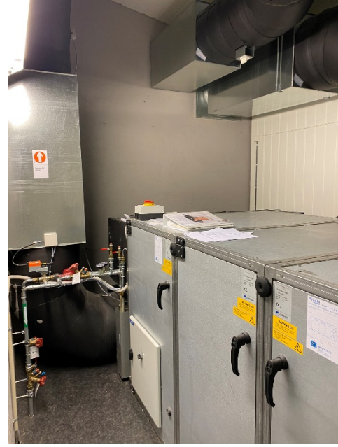
Plassering: Spesialfløya, 103a, teknisk rom tilknyttet gymnastikksal EE-type: Ventilasjonsaggregat, merket med 2011
