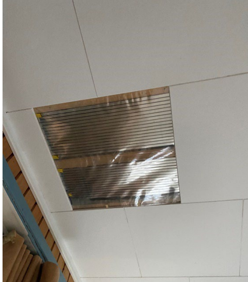
Plassering: 2. etg. nyfløya EE-type: Eswaplater/varmefolie i himling
