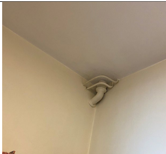
Plassering: Gammelfløya, 1. etg. Materialtype: Rørgjennomføring og soilrør Antall: 3 stk.
