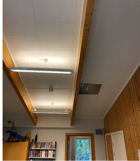
Plassering: 2. etg. nyfløya EE-type: Eswaplater/varmefolie i himling
