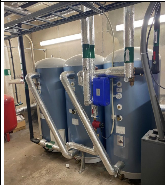
Plassering: Gammelfløya, fyrrom EE-type: Varmtvannsberedere
