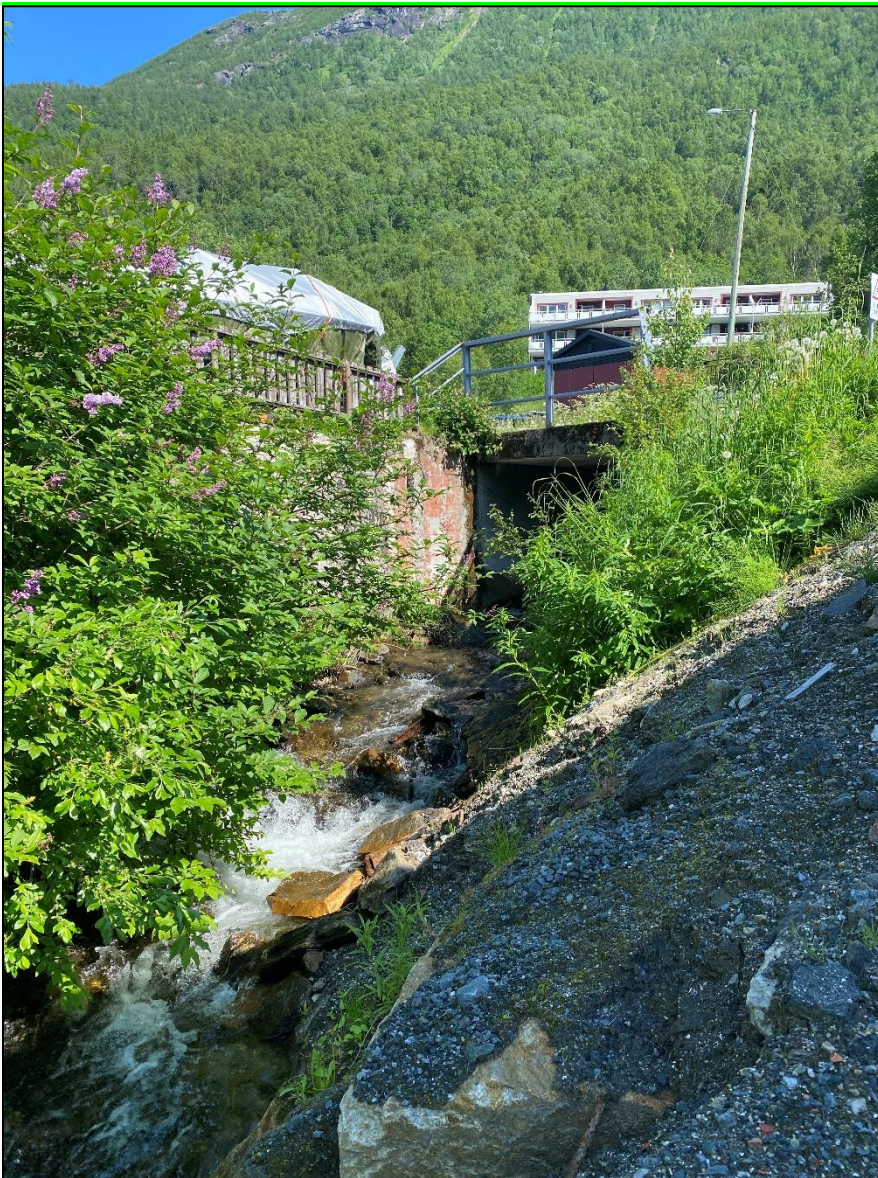
Figur 28 Nedenfor Lyngveien, erosjon har fjernet sikringstiltak. Tydelige spor etter nylig aktivitet. Stor kum under Lyngveien med god plass.
