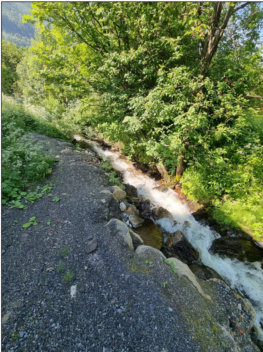
Figur 14 Nedsiden av Lyngveien, tidligere erosjonssikring er tydelig svekket.
